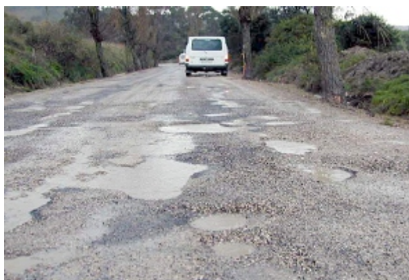
Irregularidade longitudinal do pavimento
