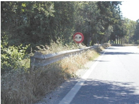
Extremidade de guarda de segurança
